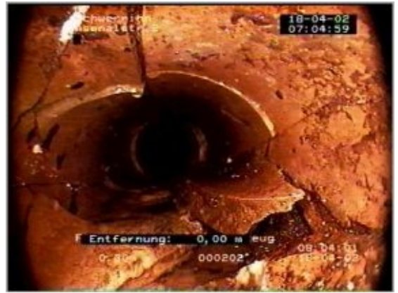
Trümmerbruch in Rohrleitung vor der Sanierung
