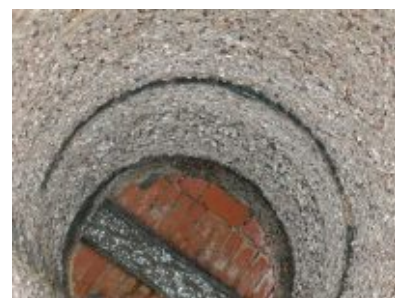
Schacht nach der Reinigung Zu sehen ist die offenporige "Waschbeton"-Struktur der Wandung
