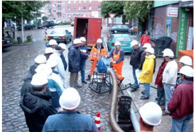
Mitarbeiterinnen und Mitarbeiter der Kieler Stadtentwässerung Nutzen die Maßnahmen um sich vor Ort über moderne Sanierungstechnologien zu informieren
