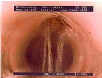
Stutzen vor Sanierung
