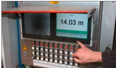
Blick auf die Steuerzentrale
